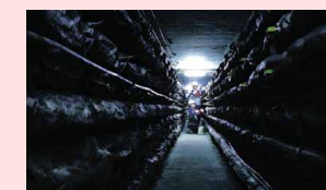
管路の長さ・29万km とう道の長さ・405km
